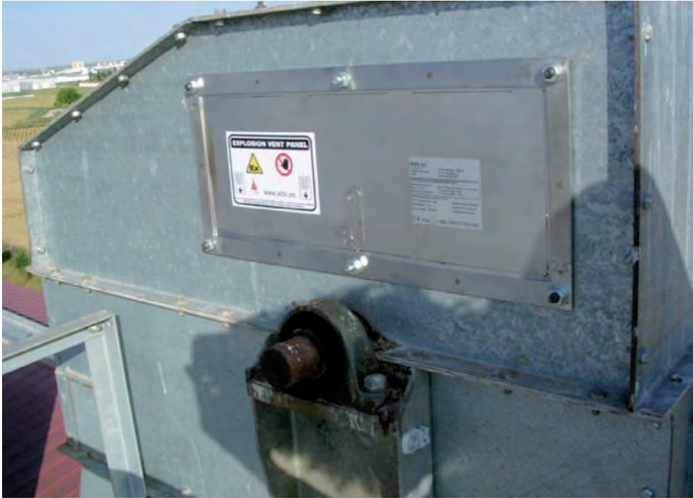
ILUSTRACIÓN 21. Montaje de venteo en elevador de cangilones (Por cortesía de Adix.)
