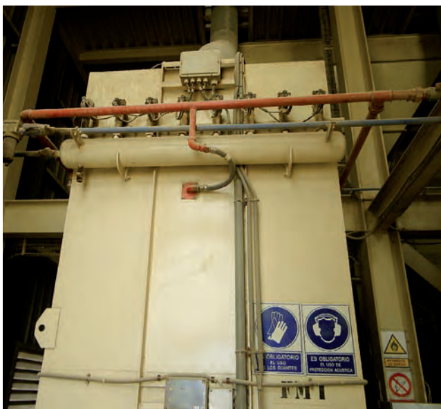
ILUSTRACIÓN 28. Extinción de incendios en filtro de mangas (Por cortesía de Nanta)
