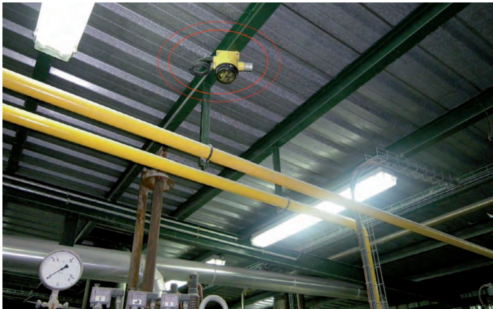
ILUSTRACIÓN 6. Detección de Gases
