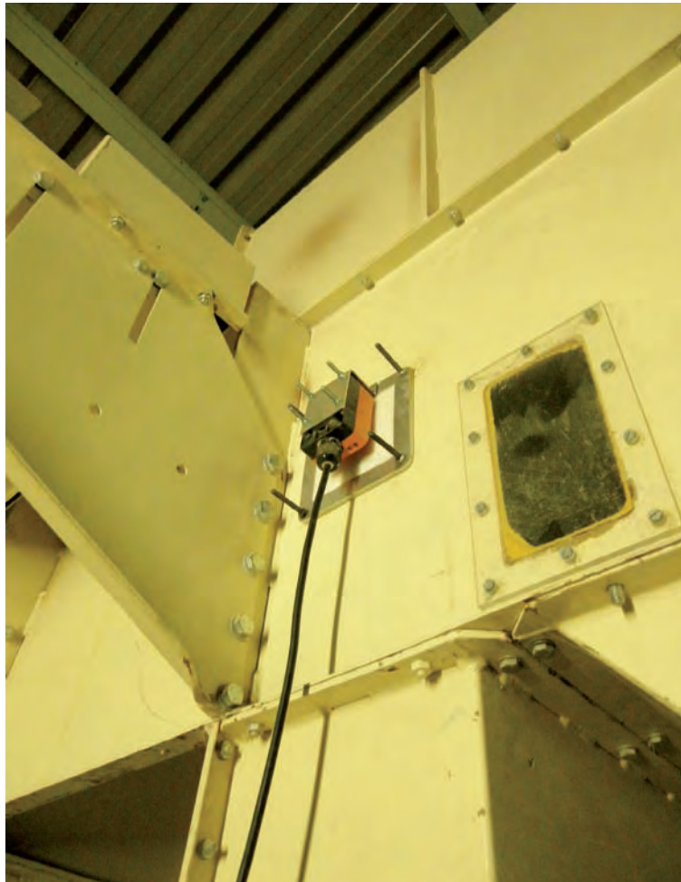
ILUSTRACIÓN 12. Detector desvío de banda en elevador de cangilones (Por cortesía de Skretting)
