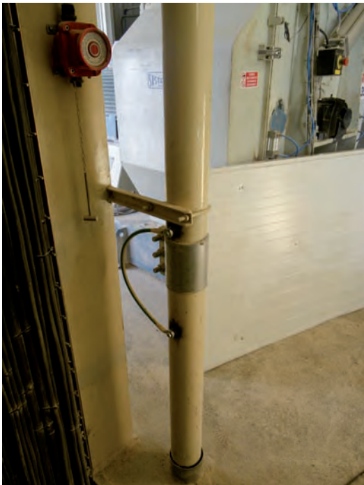
ILUSTRACIÓN 8. Cable de continuidad en conducto de transporte neumático
