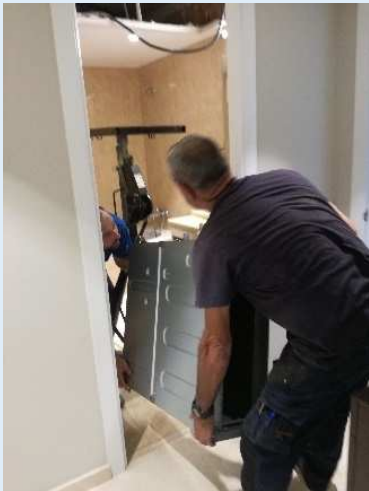
Manipulación de equipos
