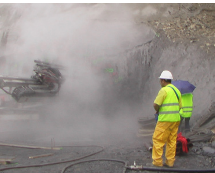
Perforación con trabajadores en los alrededores sin proteger (Imagen 5).
