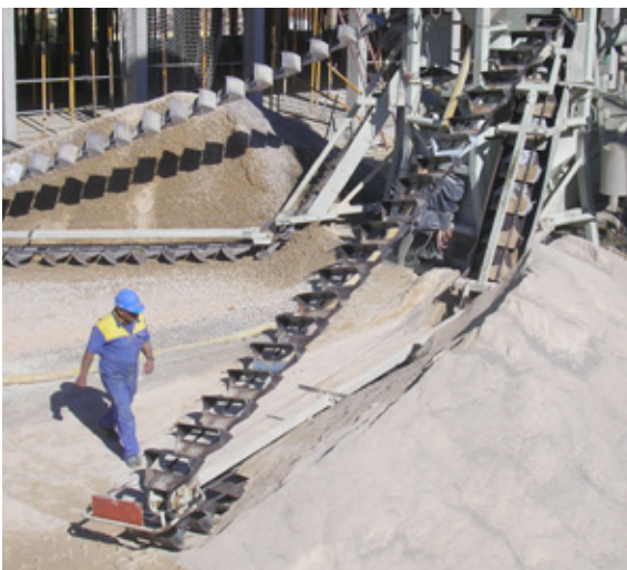
Falta de procedimiento de control de polvo en el acopio de áridos (Imagen 3).
