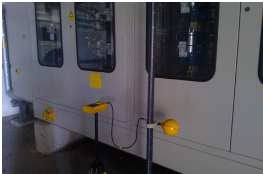
Figura 3.6. Mediciones efectuadas cerca de un rectificador de tiristores
