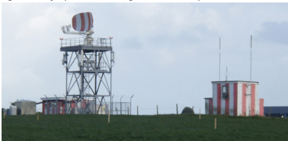
Figura 12.1. Ejemplo de radar de vigilancia de un aeropuerto
