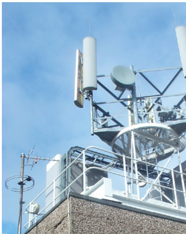
Figura 10.1. Antenas sectoriales de telefonía móvil y una antena de disco para transmisión de microondas en el tejado de la caja del ascensor
